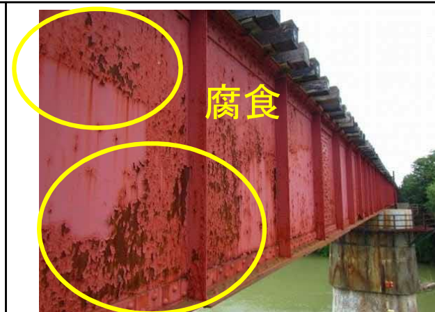
腐食が発生した橋りょう
