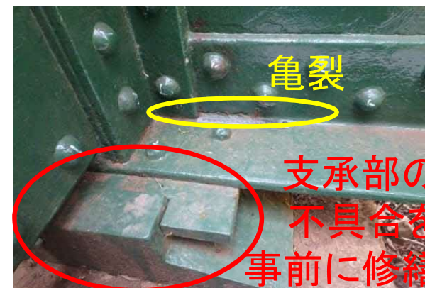
亀裂が発生した橋りょう
