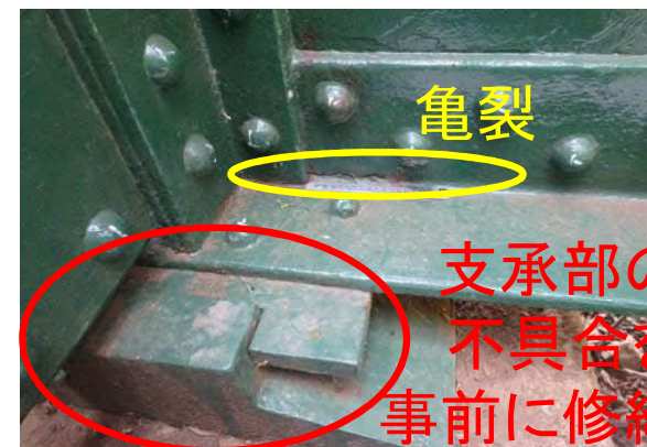
亀裂が発生した橋りょう
