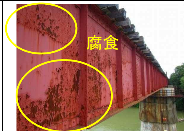
腐食が発生した橋りょう
