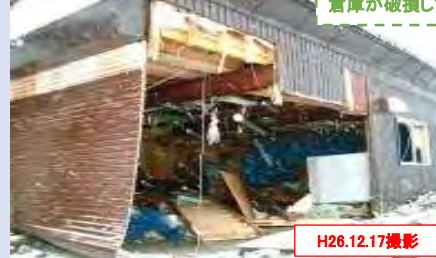
高潮被害により 倉庫が破損している
