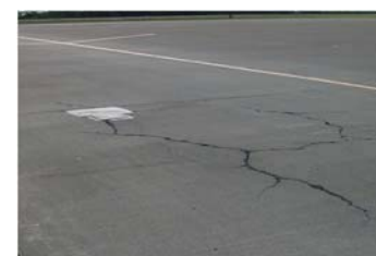
エプロン劣化状況
