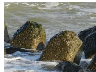
消波ブロックの摩耗状況
