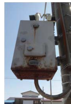
交通信号制御機の老朽化状況
