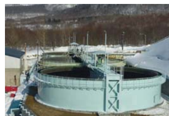
沈降分離槽(幌別硫黄鉱山)
