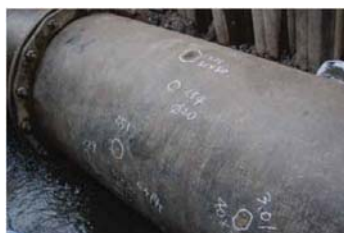
配水管 (室蘭地区工業用水道)
