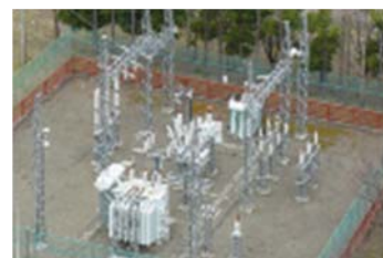
電線路[送電設備] (岩尾内発電所)
