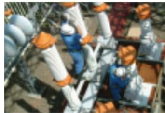
定期点検(送電機器)
