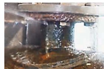
配水管の老朽化状況
