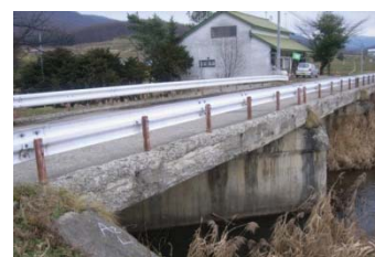
橋梁の老朽化状況
