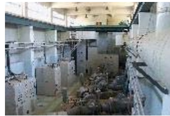
ポンプ設備 (苫小牧地区工業用水道)
