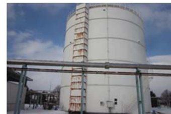
ガスホルダーの老朽化状況
