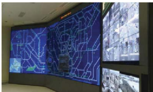
交通管制センター
