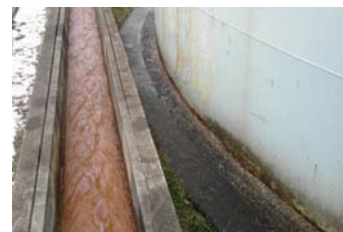
沈降分離槽の老朽化状況
