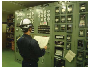
巡視点検(制御装置)
