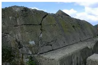
外郭施設の老朽化状況 (上部コンクリートの欠損・ひび割れ)
