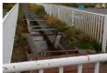
用水路の老朽化状況
