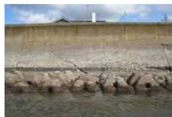
護岸の老朽化状況
