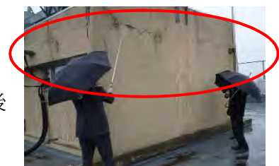
外壁の老朽化状況
