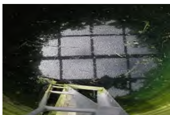
地すべり防止施設(集水井) の排水不良状況
