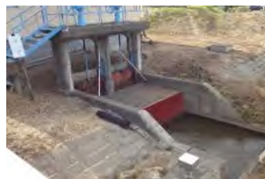
用水機場の老朽化状況
