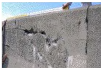
海岸保全施設(護岸) の損傷状況
