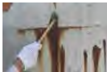
防災ダム(洪水吐) の劣化状況
