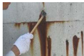
防災ダム(洪水吐) の劣化状況
