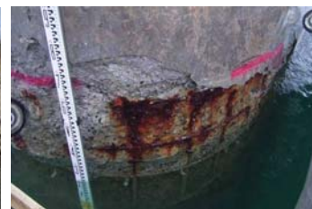
水門の老朽化状況
