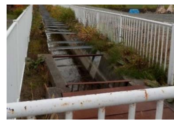
用水路の老朽化状況
