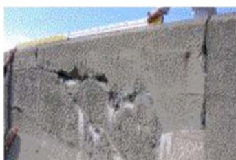
海岸保全施設(護岸) の損傷状況
