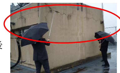
外壁の老朽化状況
