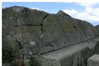
外郭施設の老朽化状況 (上部コンクリートの欠損・ひび割れ)
