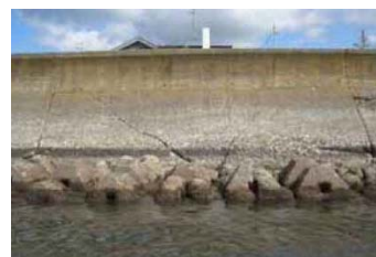
護岸の老朽化状況
