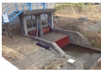
用水機場の老朽化状況
