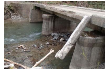
林道橋梁の老朽化状況 （地覆の破損）
