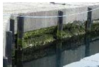
係留施設の老朽化状況 (堤体工の汀線際の劣化・損傷)
