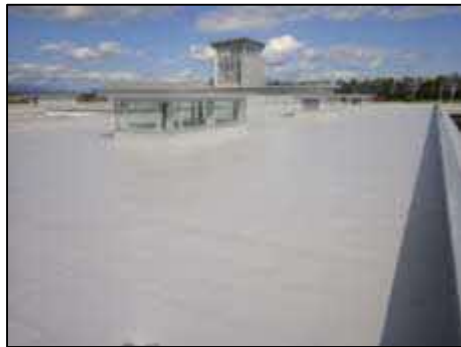
写真③ 屋上防水改修工事 （酪農試験場研究庁舎<中標津町>）
